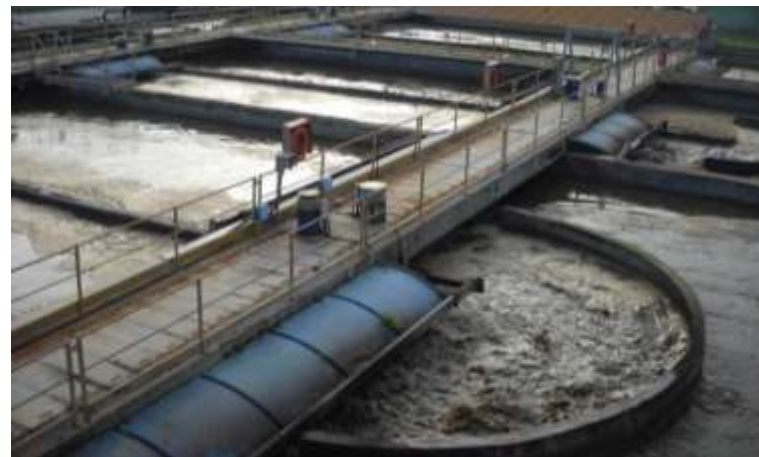
Depuratore di Viareggio (dal 1973)
